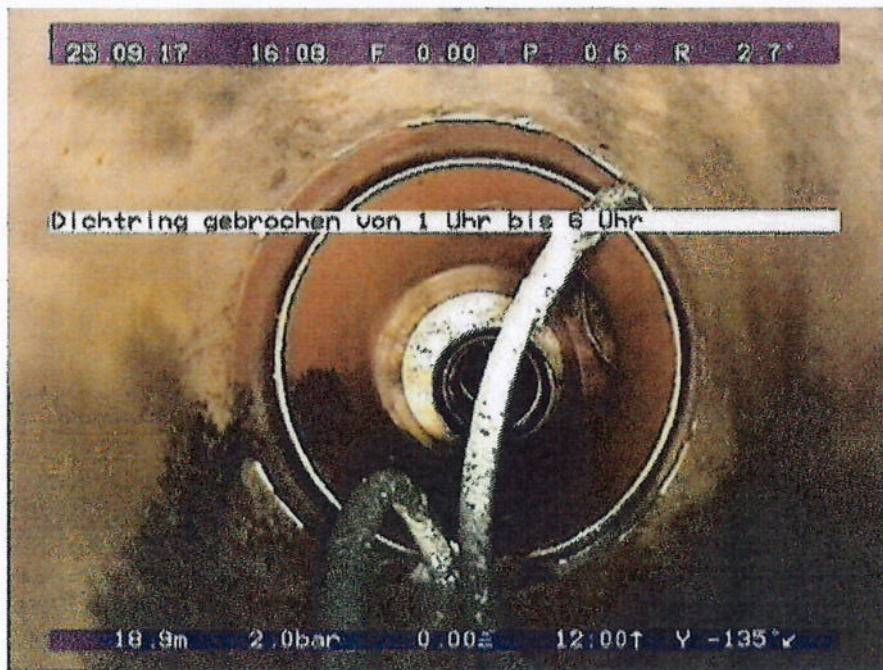
124'02_124'03_e55561c7-acd8-486d-b78f-082aa68b08c0_20170925_160855_058.jpg, 00:05:39, 18.98 Dichtring gebrochen von 1 Uhr bis 6 Uhr
